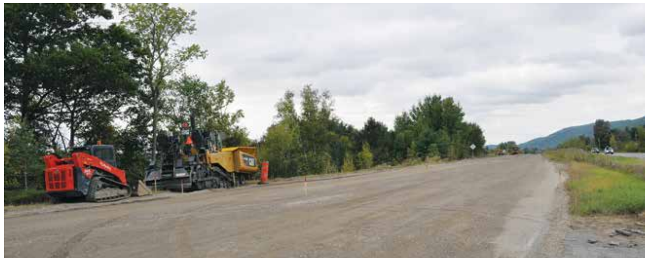
De la machinerie lourde est toujours présente aux abords de la route 148 après que le gouvernement a brusquement interrompu le projet de réasphaltage. (CH)
